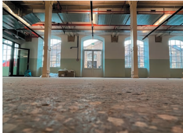
Fertig geschliffener Gussasphalt, Poren und Lunker nicht verschlossen
